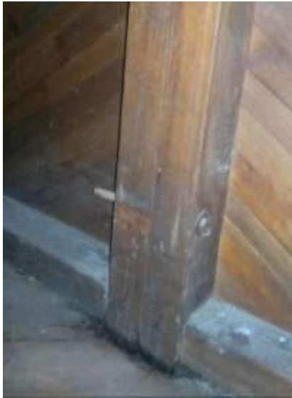
Gambar 9a. Damp pada pilar utama
