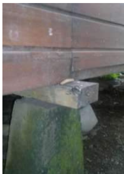
Gambar 8b. Damp pada pondasi kayu
