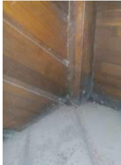
Gambar 9b. Damp pada sudut bangunan
