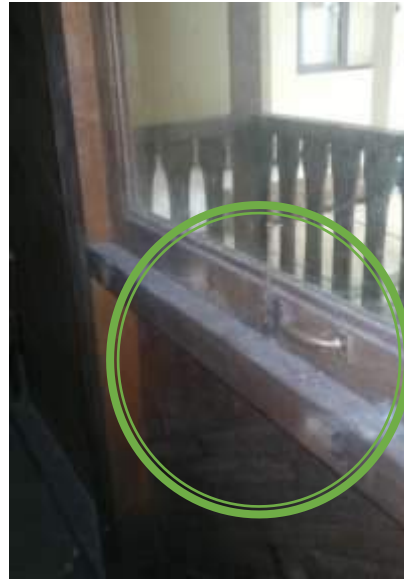
Gambar 11b. Debu tebal pada kusen jendela dan slot jendela digantikan dengan paku mengurangi keindahan
