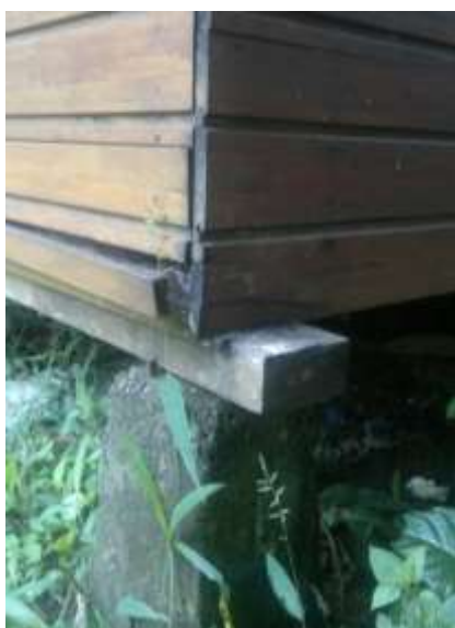
Gambar 8a. Damp pada bagian dinding luar
