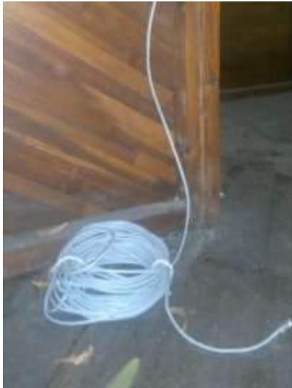
Gambar 16. Fasilitas jaringan internet kabel
