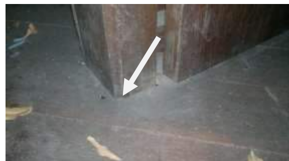
Gambar 15. Ada celah antara dinding lantai dan pilar kayu
